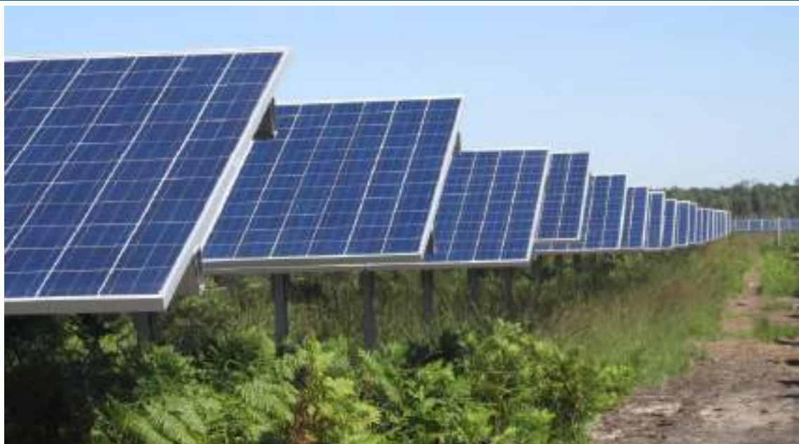
Développement de la végétation sous les panneaux (source : NEOEN)
